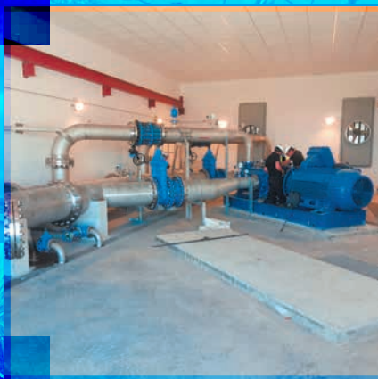
Station de pompage PISUD BP4 de 350 l/s
