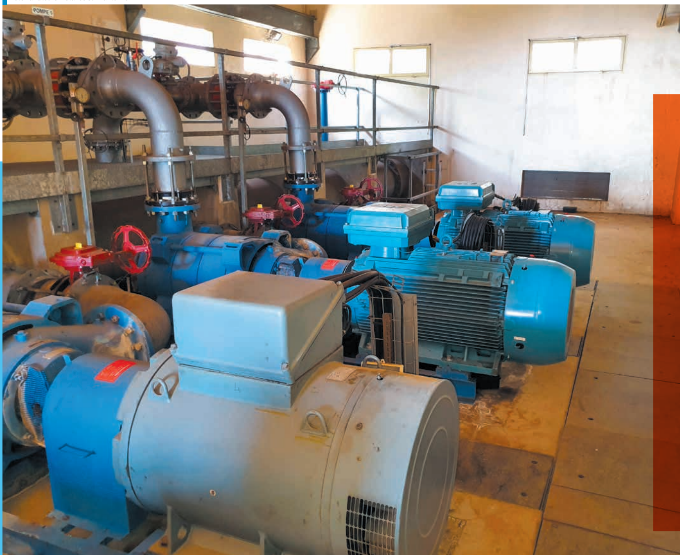
Moto variateurs installés sur l'antenne 4.
