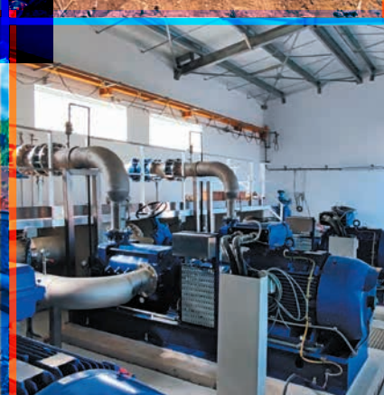
Station de pompage Bassin Martin BP3
